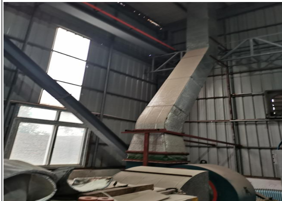
废气处理设施
