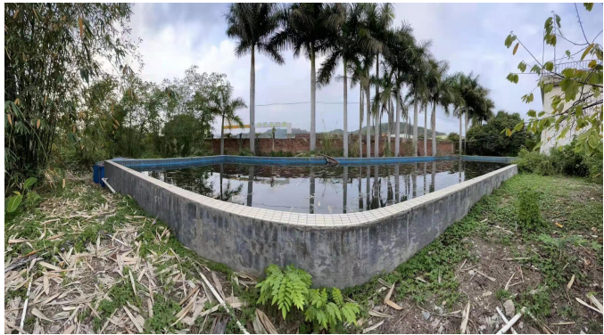
现场消防水池
