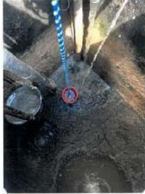
废水处理设施进口 A#
