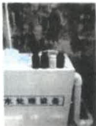
生活污水一体化设施出水口
