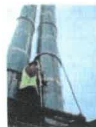
抛光车间2排气筒 (DA002) 处理后
