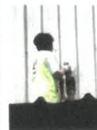
抛光车间3排气筒 (DA003) 处理后
