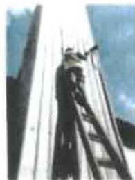
抛光车间1排气筒 (DA001) 处理后
