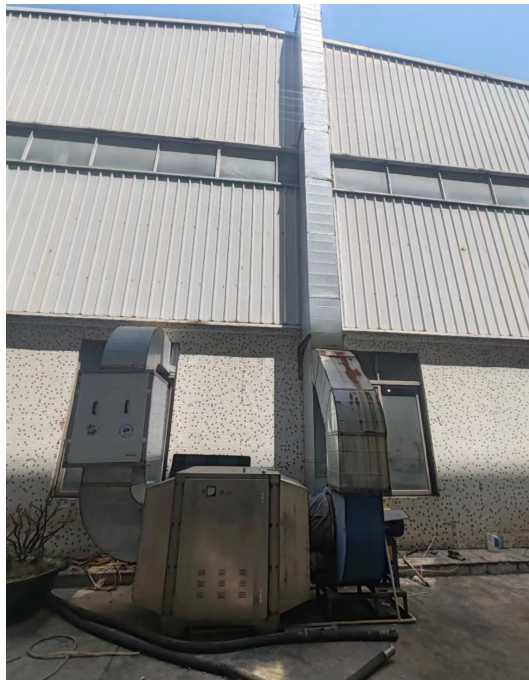
图 2-5 现有项目废气处理设施
