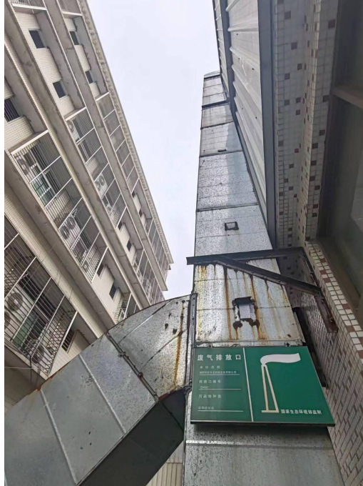
图 2-4 现有项目废气排放口
