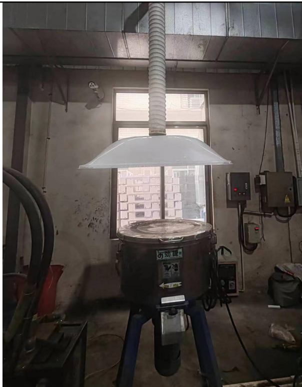
图 2-6 现有项目粉尘废气集气设备
