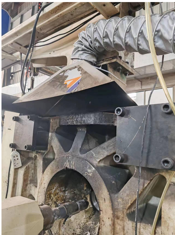
图 2-7 现有项目有机废气集气设备
