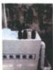
生活污水一体化设施 出水口
