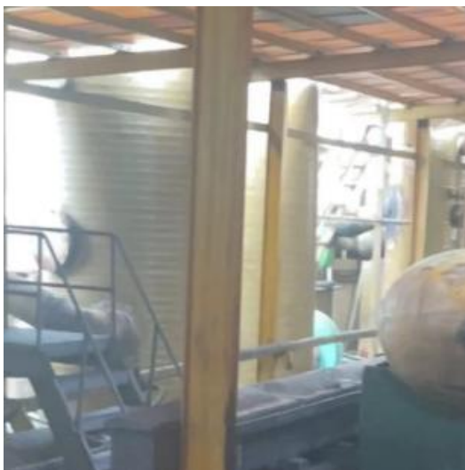
酸雾净化设施
