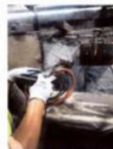
抛光车间3排气筒 (DA003) 处理前
