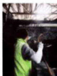
抛光车间1排气筒 (DA001) 处理前
