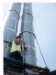
抛光车间2排气筒 (DA002) 处理后
