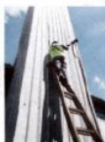
抛光车间1排气筒 (DA001) 处理后
