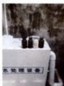
生活污水一体化设施 出水口
