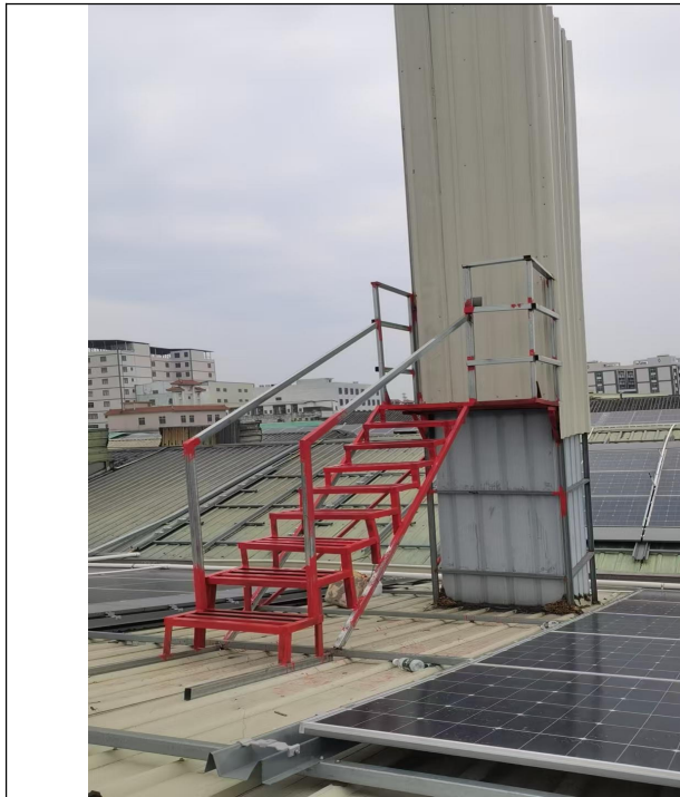
项目排气筒现场图片
