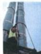
抛光车间2排气筒 (DA002) 处理后
