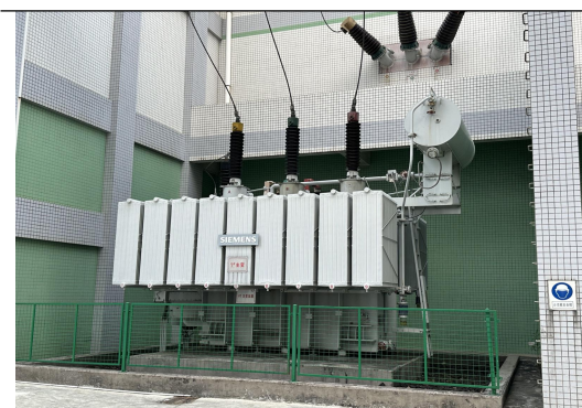
现有#1 主变位置
