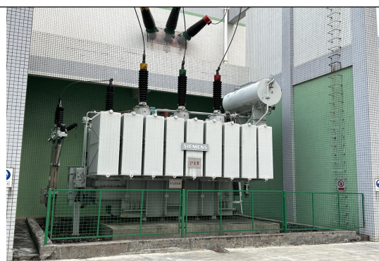
现有#2 主变位置
