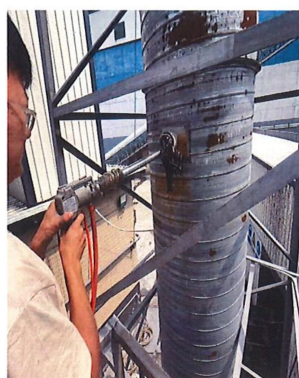
烘干废气排放口 DA004
