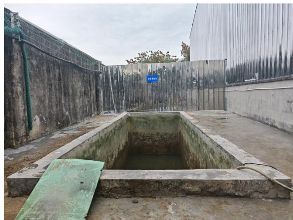
应急事故池（雨水管网设置排水管道连接应急事故池）
