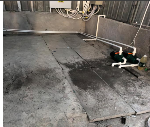
喷淋废水循环沉淀池
