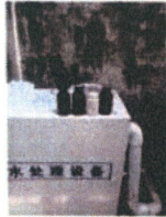
生活污水一体化设施出水口
