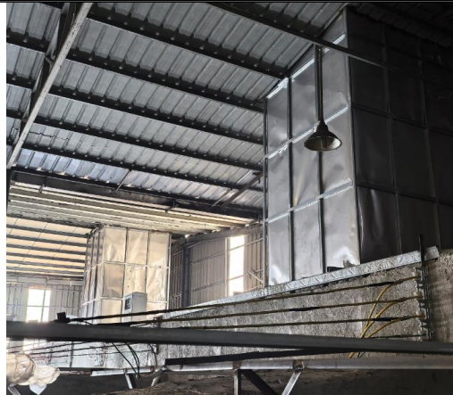
现有项目废气排放口
