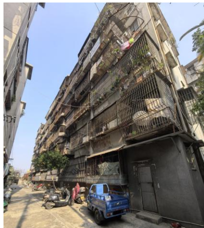
图 4-31 风貌不协调的建筑
