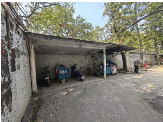
图 4-34 风貌不协调的建筑
