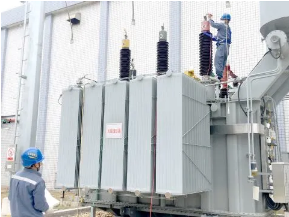
揭阳供电局工作人员开展110kV（千伏）枫口变电站3号主变周期性高压预试工作，确保变电设备安全可靠运行。倪晓鸣 摄
