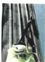
抛光车间4排气筒 (DA004)处理后
