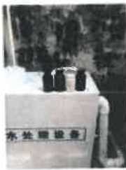
生活污水一体化设施 出水口
